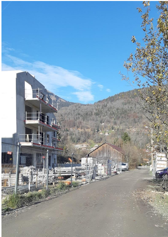
Vue de la route des Drugères depuis la future raquette de retournement, avec la résidence MMV sur la gauche
